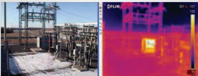
Цифровое фото и ИК-изображение подстанции с перегревшимся трансформатором
